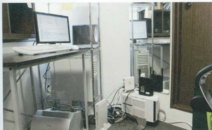
受付カウンター裏の控え室には近藤氏自ら設定した各種サーバがある。レセプトコンピュータのサーバはLinuxベースだが、これも近藤氏が設定したという
